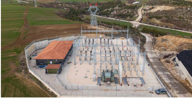
Safi Çimento Substation, Bilecik
